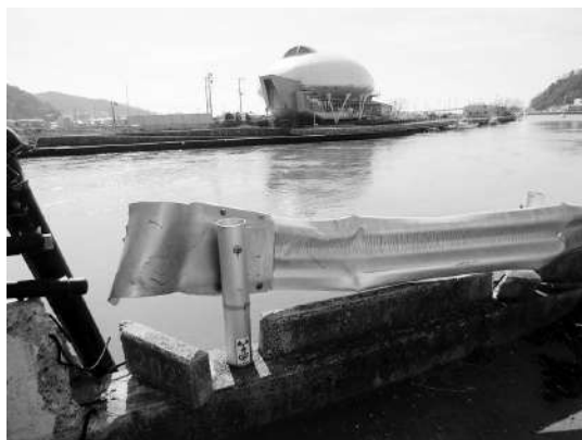
写真3：石巻市内の被害状況
