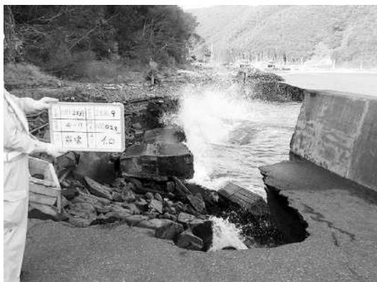
津波により破堤した防潮堤（その1）
