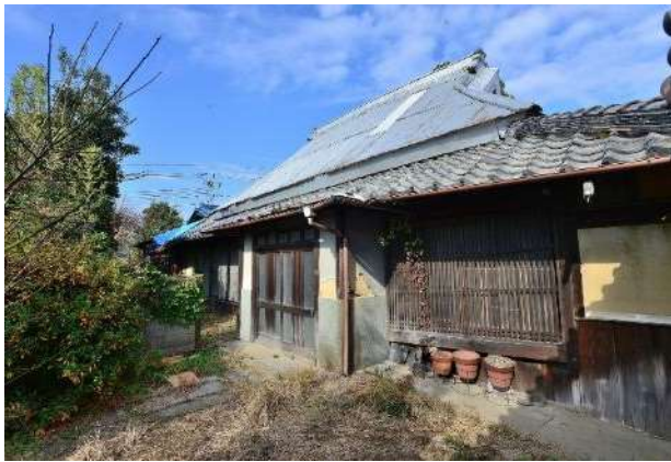
主屋玄関周りを見る。風情を感じさせる木製建具や木格子が残っているが、木格子や漆喰壁、杉板張りとも腐朽劣化が進んでいるため、撤去、更新が望まれる。
