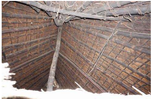
主屋茅葺屋根の小屋裏を見上げる。小屋組みは又首組と古材が用いられた棟束の併用となっている。屋中、垂木には丸太が用いられ、竹木舞下地は整然と組まれている。
