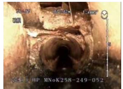
汚水管渠の老朽化
