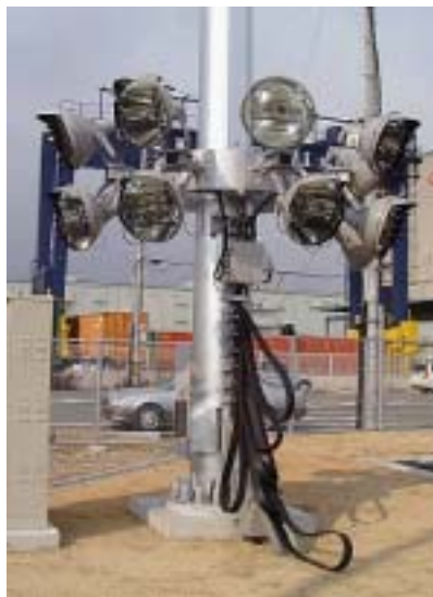
昇降式照明塔 (器具を降ろした状態)
