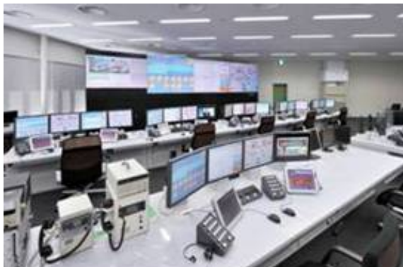
消防管制システム（ALT-FACE）
