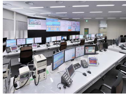
消防管制室の状況
