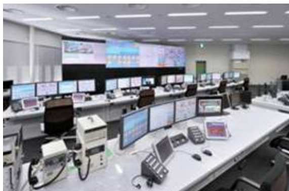
消防新管制システム(ALT-FACE)
