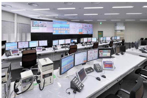
消防管制室の状況
