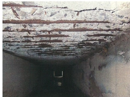
雨水管・頂版部の鉄筋腐食
