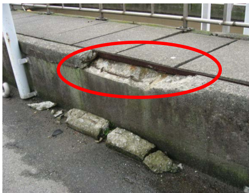
躯体コンクリート劣化による損傷 （西部処理場）
