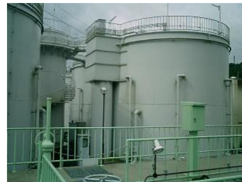
※活性炭吸着槽
