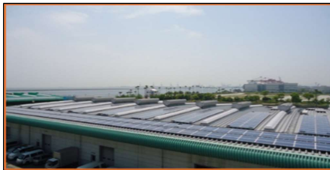
図 19 臨海部の屋根上太陽光発電設備
