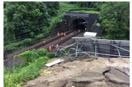
＜神戸市内の事例＞（平成 30 年 7 月豪雨による崩落）
