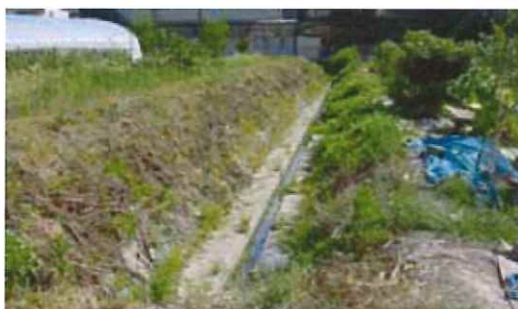
大雨の時に排水がしにくい水路
